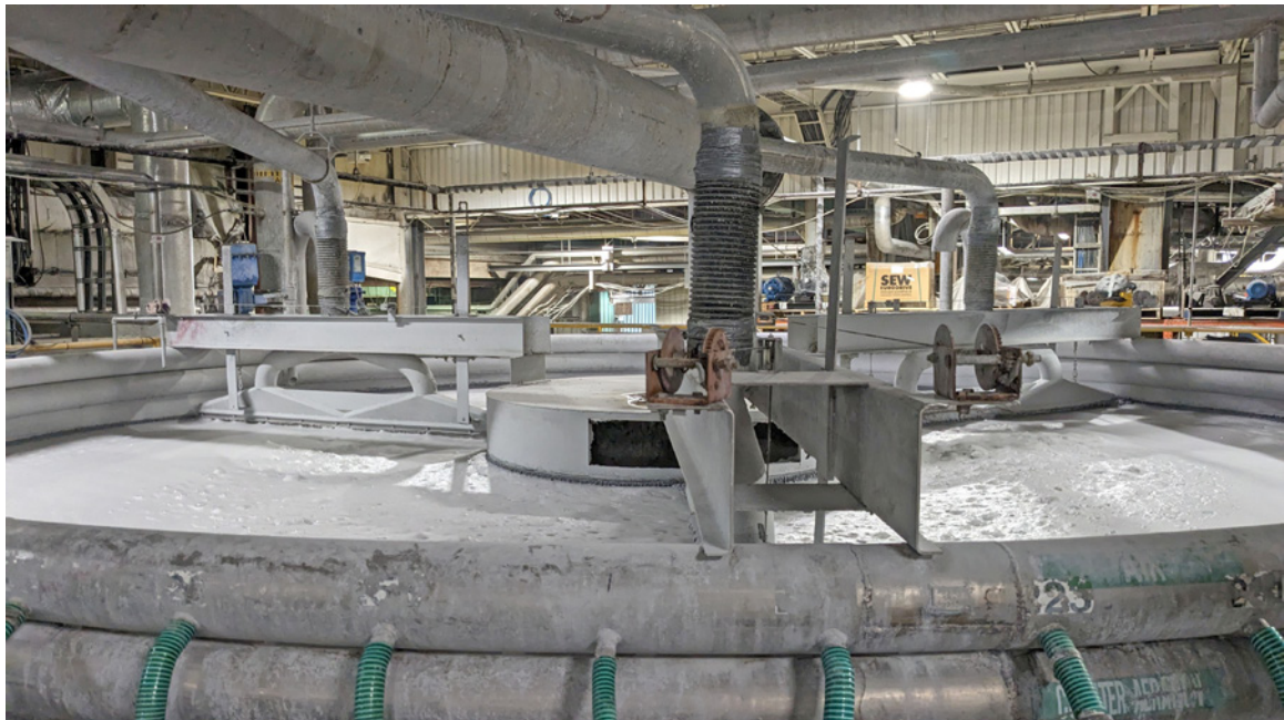
Figure 3.26 Cellule de flottation dans l'usine de désencrage Fibres Sustana de Breakeyville
